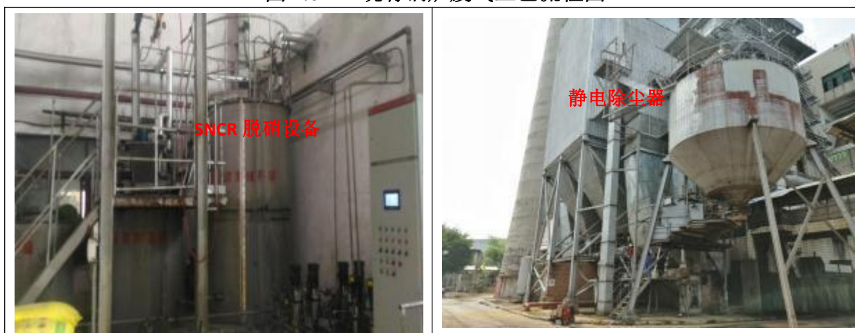
图 2.6-3 现有锅炉废气处理措施现状图
